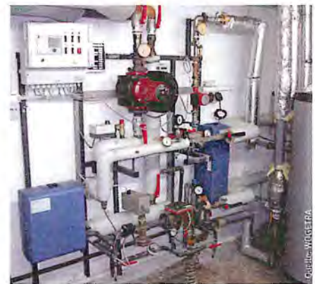
Heizanlage der WOGETRA in der Hans-Beimler-Straße
